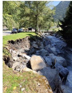
Enrochements endommagés près du camping du Moudang après la crue de septembre 2024 (photo : PETR)
